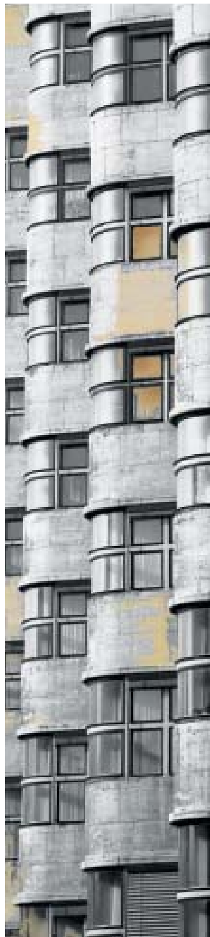
Ohne SISTAN: Durch Schwefelwasserstoff und Sauerstoff aus der Luft hat sich Silbersulfid gebildet und eine gelbbraune Verfärbung verursacht.
